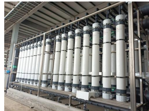
UF membrane system
